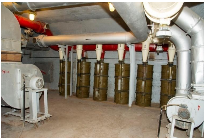
Фильтровентиляционное оборудование убежища
